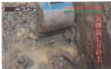
擁壁の中は瓦礫混じりの土 さらに地中から水が湧き出ていました。
