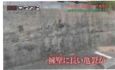
支える擁壁に13mの亀裂が……
